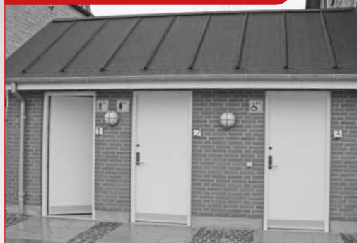
Dørautomatik installeret i offentlig bygning
