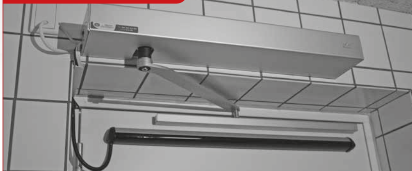
Dørautomatik installeret i toiletbygning
